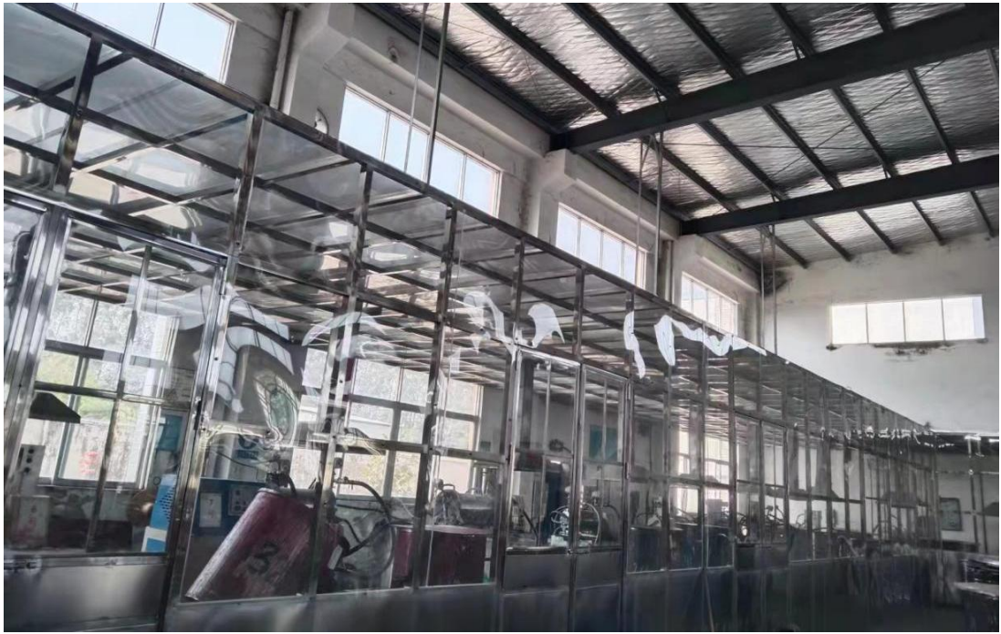
车间废气收集措施（密闭收集）
